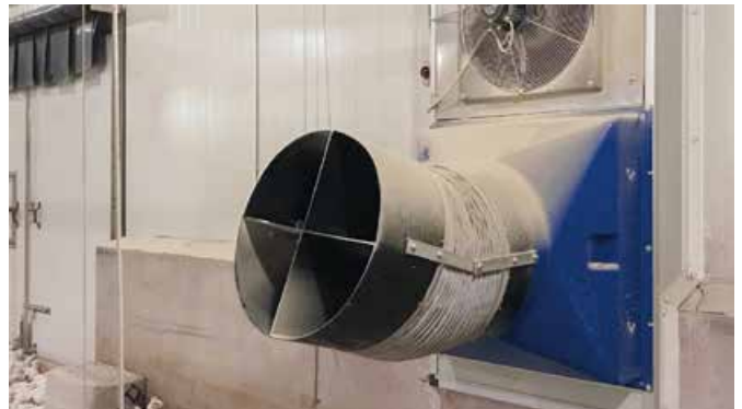
Wärmetauscher im Einsatz
